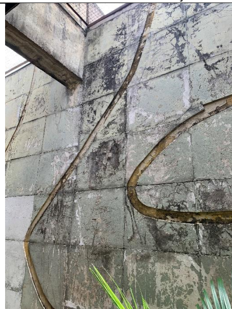
Figura 24 – Pannel de Paulo Werneck – área em péssimo estado de conservação
