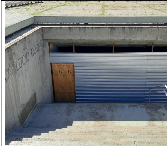
Figura 15 – Espaço Lucio Costa – vista externa do acesso que teve painéis de vidro quebrados fechado provisoriamente com tapume
