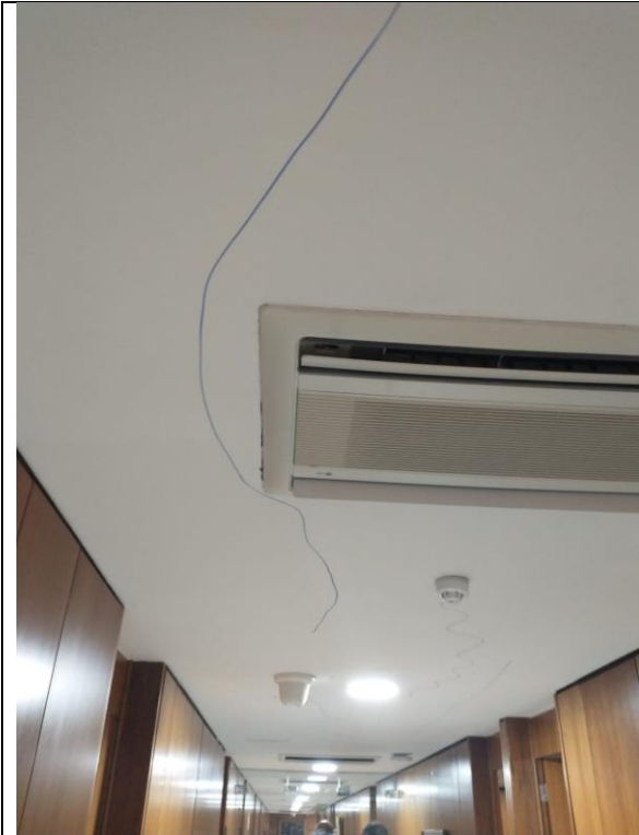
Figura 7 – O dano ao forro, riscado durante os atos de vandalismo, permanece. A pintura está prevista
