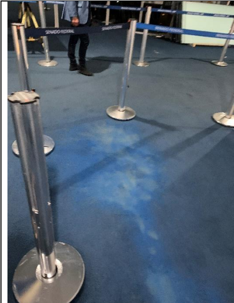
Figura 39 – Salão Azul, área próxima ao acesso ao Plenário, com carpete manchado
