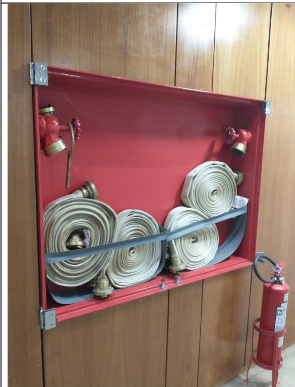
Figura 9 – Vidros quebrados de equipamentos de combate a incêndio. A substituição está prevista
