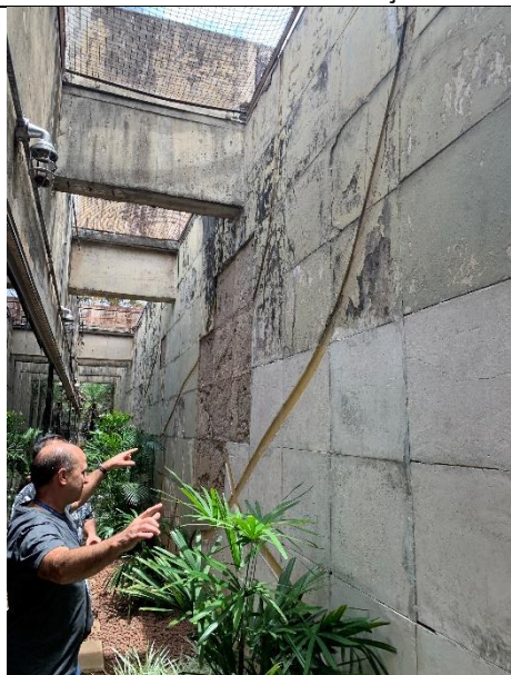
Figura 23 – Pannel de Paulo Werneck – área em péssimo estado de conservação
