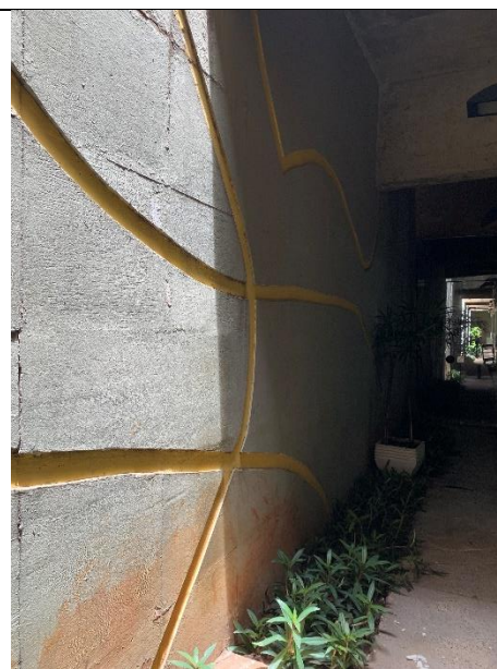
Figura 22 – Pannel de Paulo Werneck – área em bom estado de conservação
