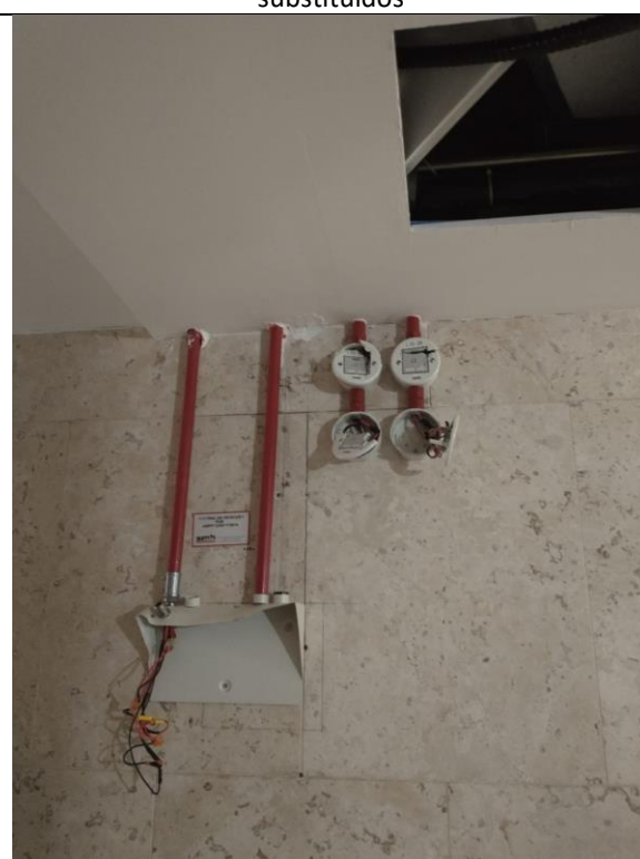
Figura 24 – Parte dos equipamentos permanecem danificados. A substituição está prevista
