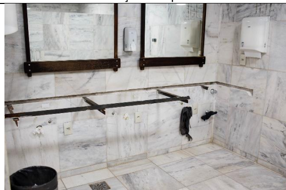
Figura 6 – Banheiro vandalizado permanece com mármore e outros equipamentos vandalizados. A substituição está prevista
