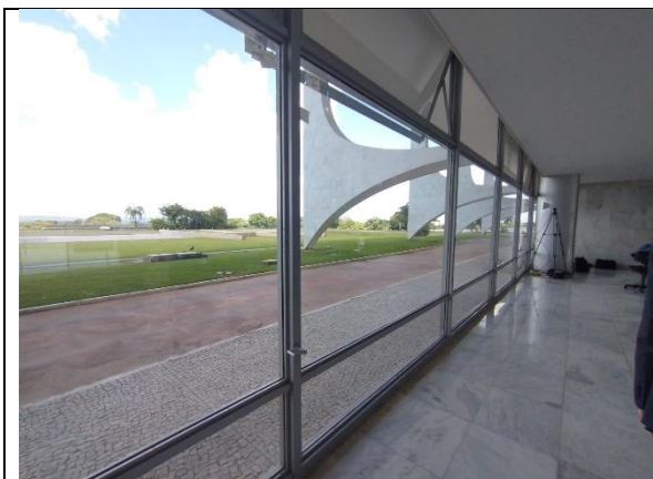
Figura 1 – Esquadrias do Térreo do Palácio, com os vidros danificados parcialmente substituídos.
