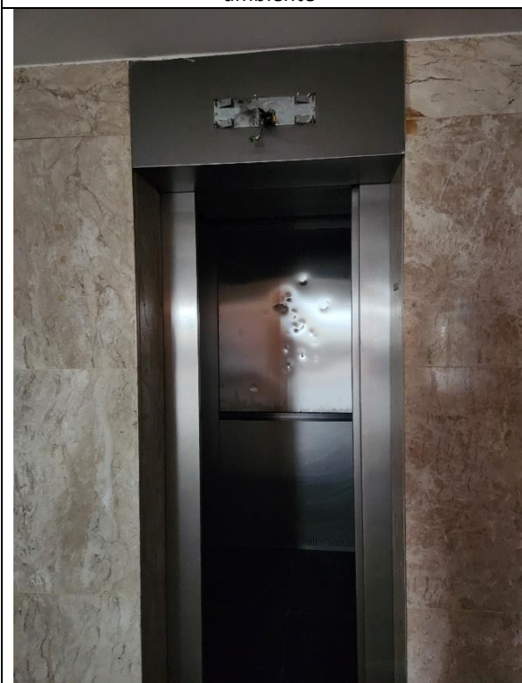
Figura 19 – Elevador ainda danificado. A recuperação está prevista
