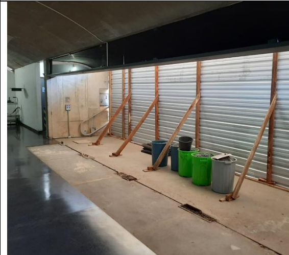
Figura 16 – Espaço Lucio Costa – vista interna do acesso que teve painéis de vidro quebrados fechado provisoriamente com tapume
